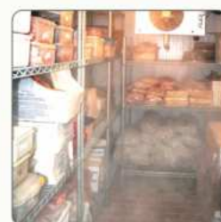
CÂMARA FRIA Câmara Fria // Cold chamber
